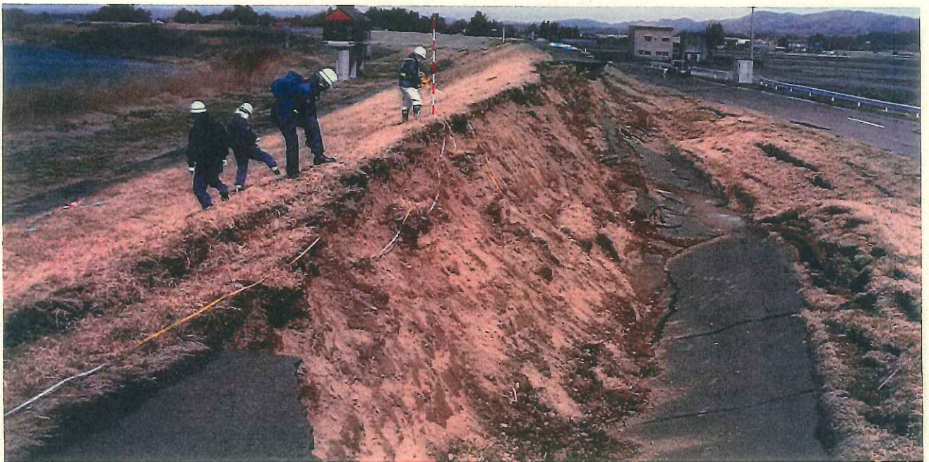
▲河川班： 阿武隈川の堤防崩落状況を調査（宮城県岩沼市）
