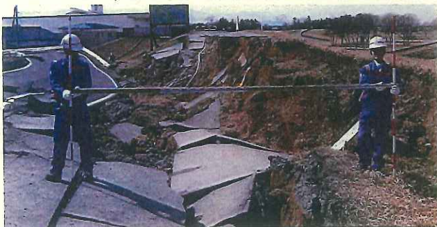
▼河川班：鳴瀬川中流部において堤防崩落状況を調査（宮城県大崎市）
