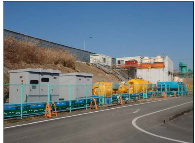
送気設備関係ヤード【全景】(右岸下流から)
