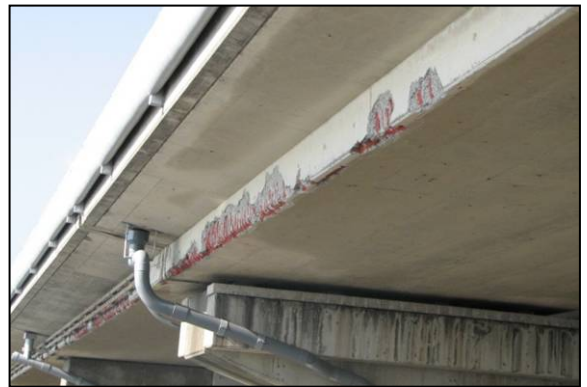
国道1号蒲原高架橋（建設後40年経過：静岡市清水区蒲原）の損傷状況
