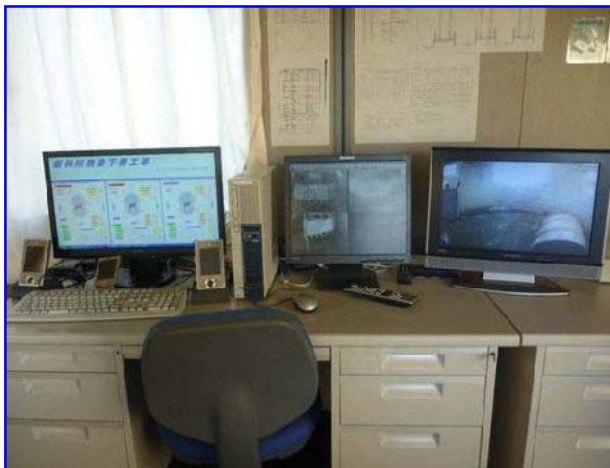
計測管理室【計測機器設置状況】
