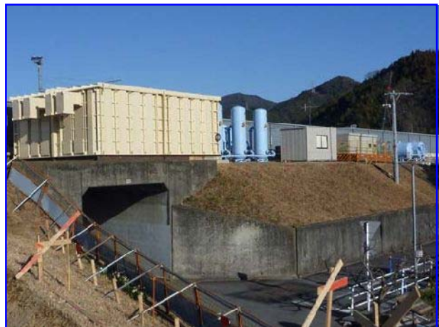
送気設備ヤード【全景】(左岸下流から)
