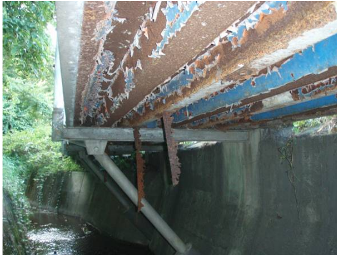
鋼材の劣化状況
