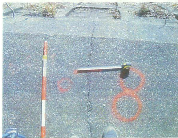
⑧変状No.① 開口亀裂 釘間19.0cm
