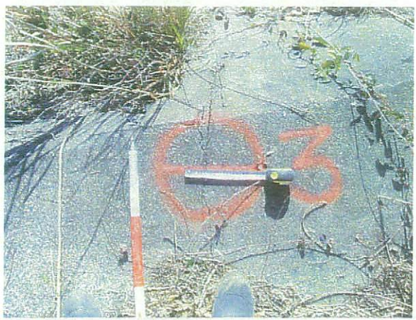
③変状No.③ 開口亀裂 釘間15.0cm
