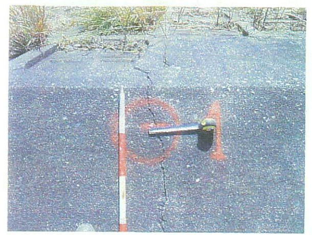
①開口亀裂 釘間6.8cm
