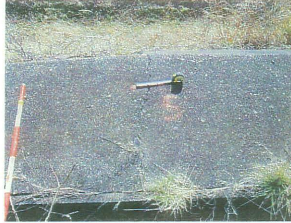
⑤開口亀裂 釘間13.7cm
