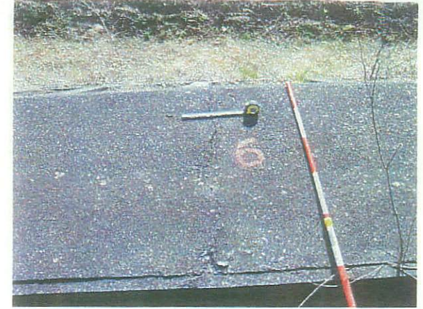
⑥開口亀裂 釘間16.5cm
