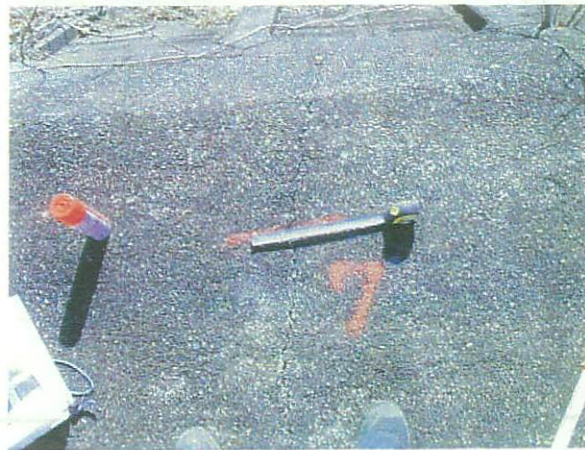
⑦開口亀裂 釘間19.5cm
