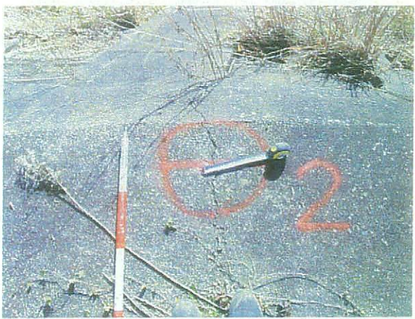
②変状No.② 開口亀裂 釘間8.0cm
