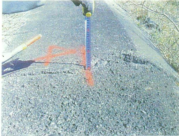
④開口亀裂 段差3.0cm
