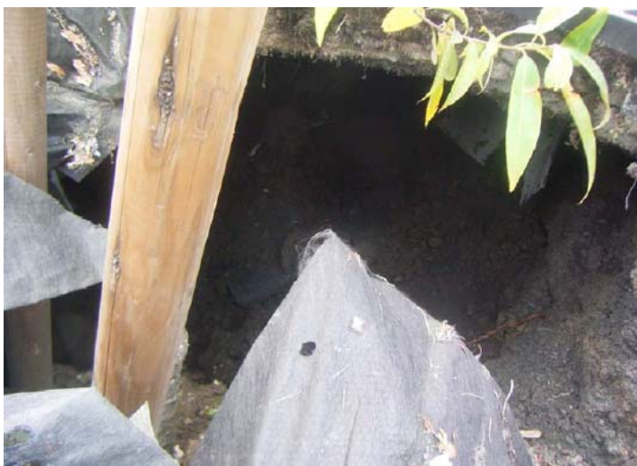
傾いた街路樹の根本部を掘り起こし、発見された空洞
