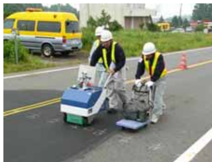
ハンディ型地下レーダによる調査 (陥没箇所付近の詳細調査)
