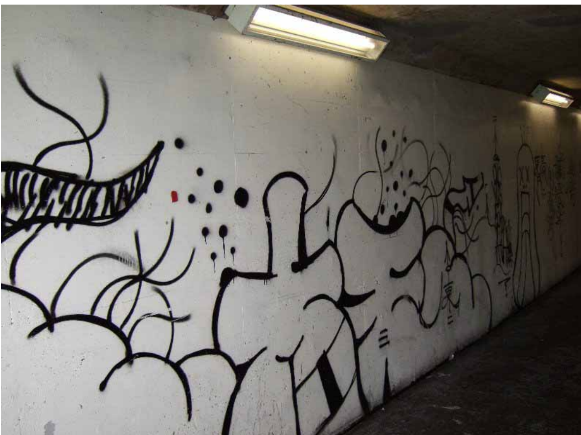
・地下道の被害の様子
