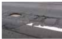
損傷した道路
