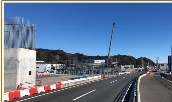
庵原川付近から東側を望む
