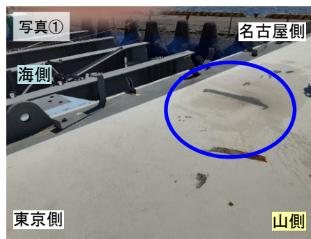
写真①橋桁上フランジに凹み
