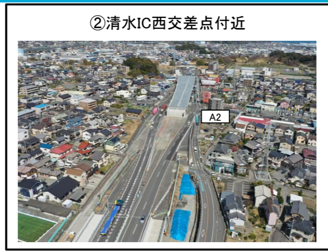
②清水IC西交差点付近 A2橋台 取付擁壁 施工完了
