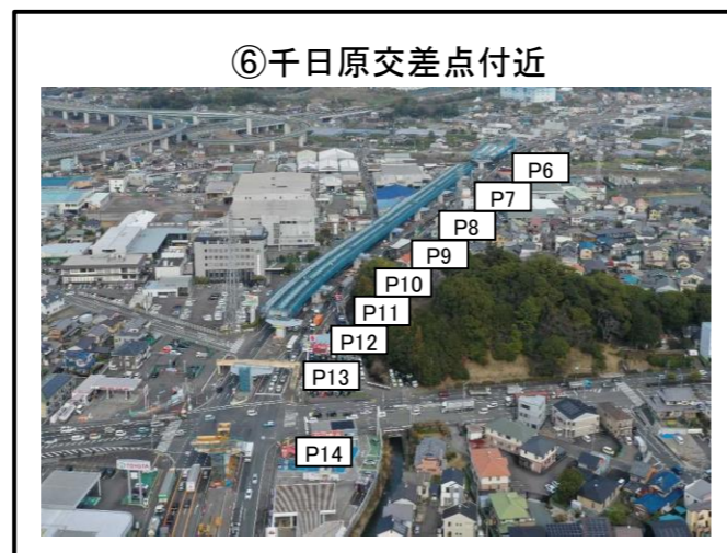
⑥千日原交差点付近 P6橋脚~P13橋脚 上部工 施工中
