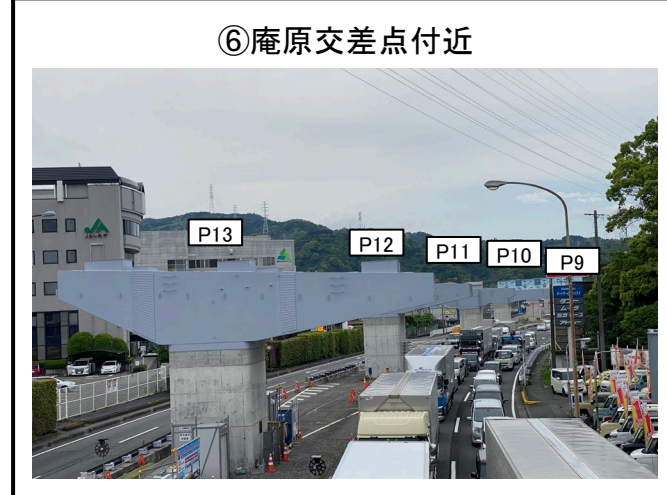
⑥庵原交差点付近 P13橋脚～P9橋脚 鋼製梁工 施工準備
