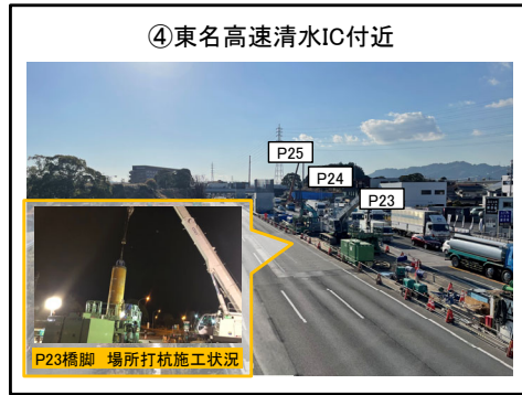
④東名高速清水IC付近 P23橋脚 場所打杭工に着手
