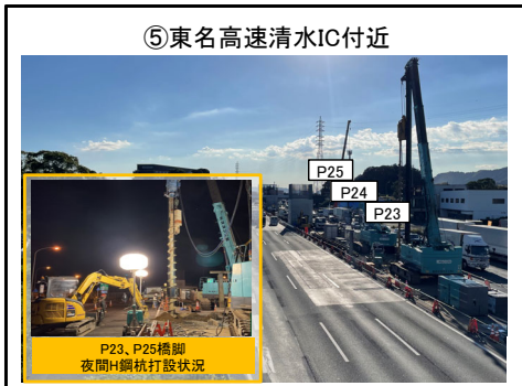
⑤東名高速清水IC付近 P23、P25橋脚 H鋼杭打設に着手
