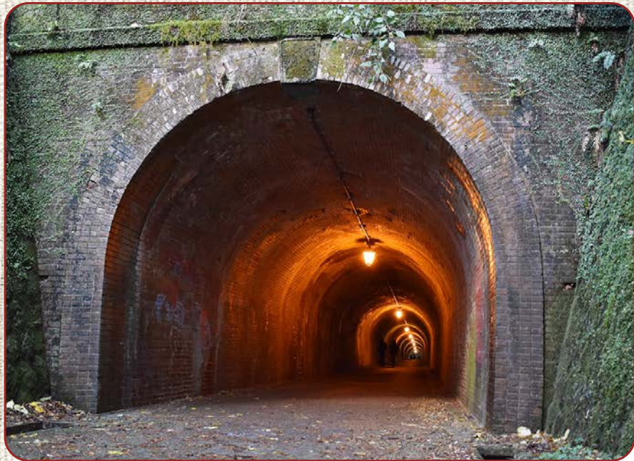
火災の後、1904年によみがえった「明治のトンネル」
