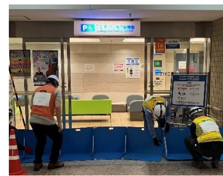
機械式駐車場への浸水を防止するため、簡易止水板も設置
