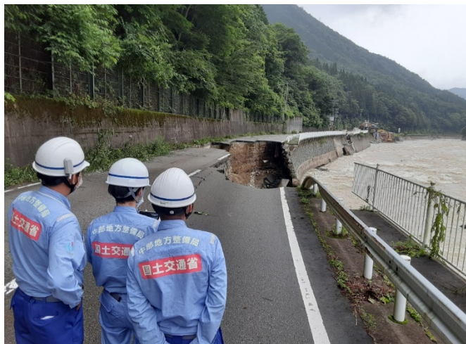
市道の崩落等の状況をドローンにて調査
