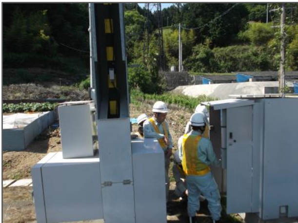
機側盤を操作し、遮断機を操作しています。
