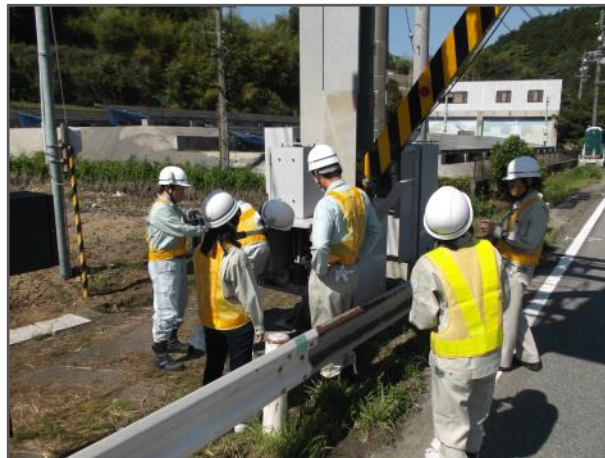
停電時を想定し、遮断機を手動で操作しています。
