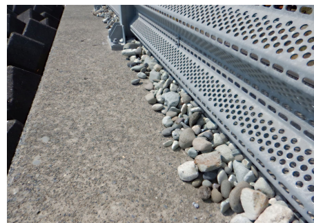
柵で受け止められた飛散物の状況(越波発生後)
