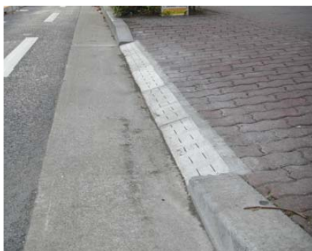
図 6-11 自転車利用者に配慮した縁石の設置事例（東京都江東区亀戸）
