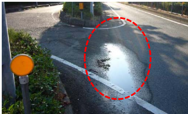
水たまりの発生しやすい箇所
