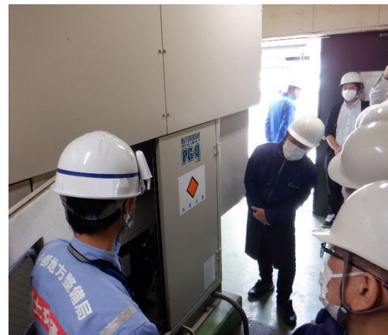
非常用発電機の確認
