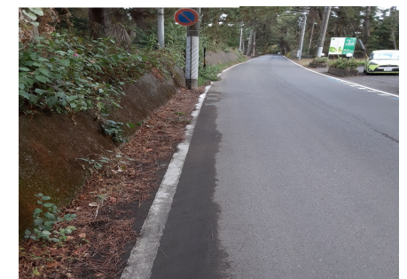
⑩ 矢羽根の劣化等
