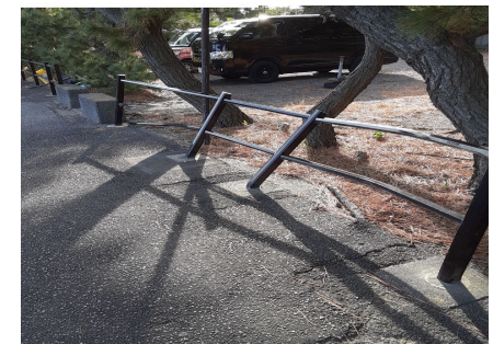
⑥ 防護柵の不足
