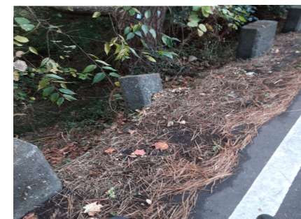
⑥ 柵が無く転落の危険
