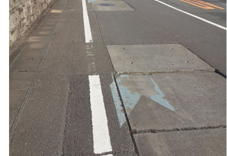
⑩矢羽根等の劣化
