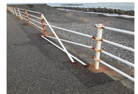
⑥柵が無く転落の危険
