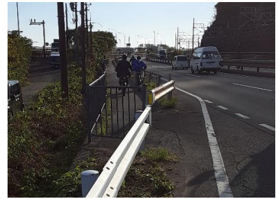
⑬ 案内誘導不足
