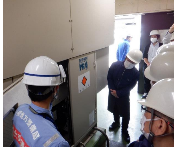
非常用発電機の確認
