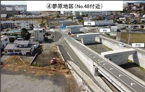
④蓼原地区 (No.48付近) P8・P9・P10橋脚 令和4年2月 施工完了
