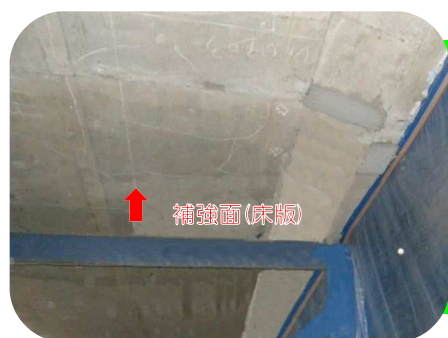
床版への炭素せんい補強前
