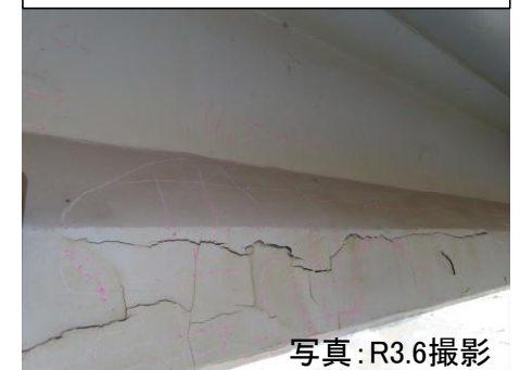
【由比川橋】主桁のうき
