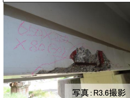
【由比川橋】主桁の剥離・鉄筋露出
