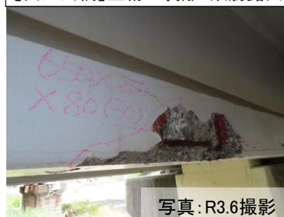
【由比川橋】主桁の剥離・鉄筋露出
