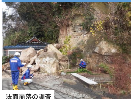
法面崩落の調査
