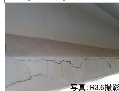
【由比川橋】主桁のうき
