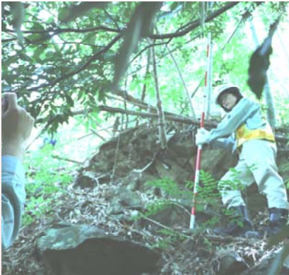
落石箇所の状況確認
