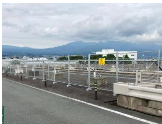
中央分離帯への進入防止のためのフェンスを設置 ※国交省により実施
