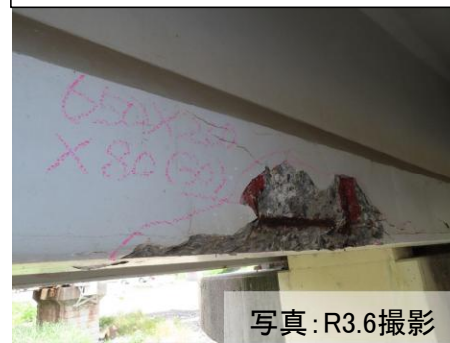
【由比川橋】主桁の剥離・鉄筋露出
