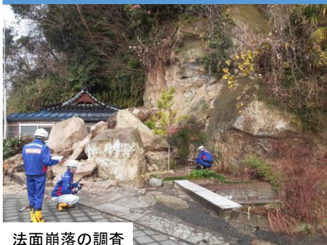
法面崩落の調査
