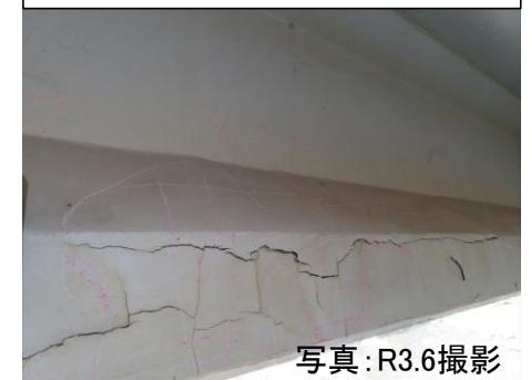
【由比川橋】主桁のうき
