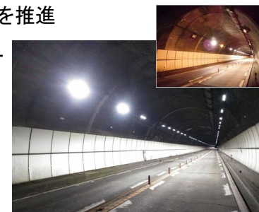
照明灯LED化(右上写真:更新前)
