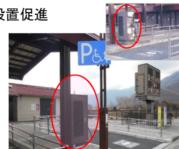
急速充電器(道の駅 朝霧高原)
