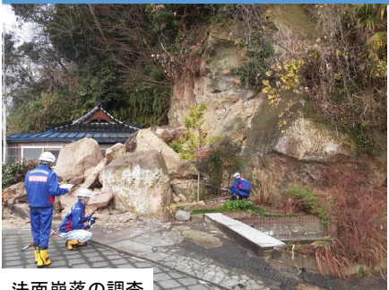
法面崩落の調査
