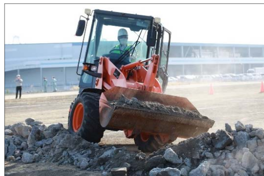
倒壊ガレキの除去
