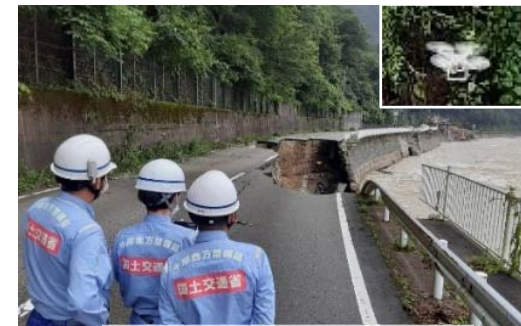
ドローンによる被災状況調査
