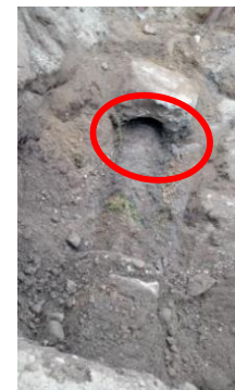
横断水路継ぎ目部に隙間が発生
