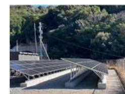
太陽光発電施設
