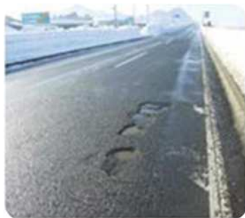
路面の穴ぼこ・ 段差
