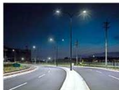
LED照明 (消費電力約56%削減)
