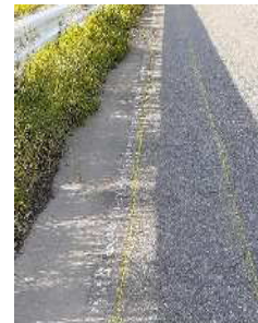
区画線の摩耗
