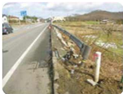
ガードレール・ 標識等の損傷
