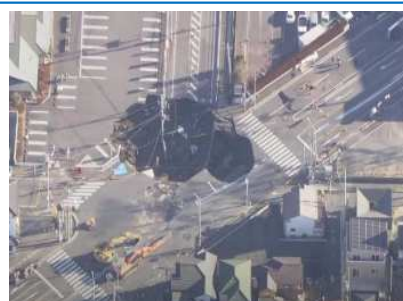
1月31日時点の事故現場の状況
