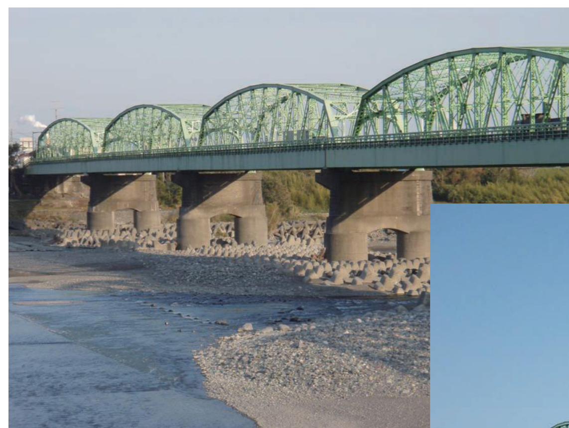
(塗装の劣化により腐食が進行)
