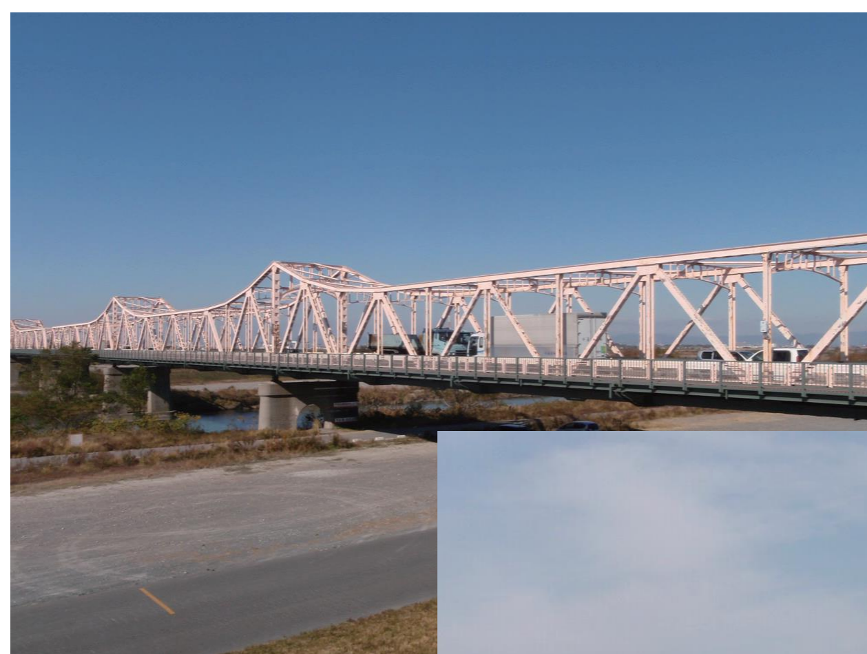
(塗装の劣化により腐食が進行)
