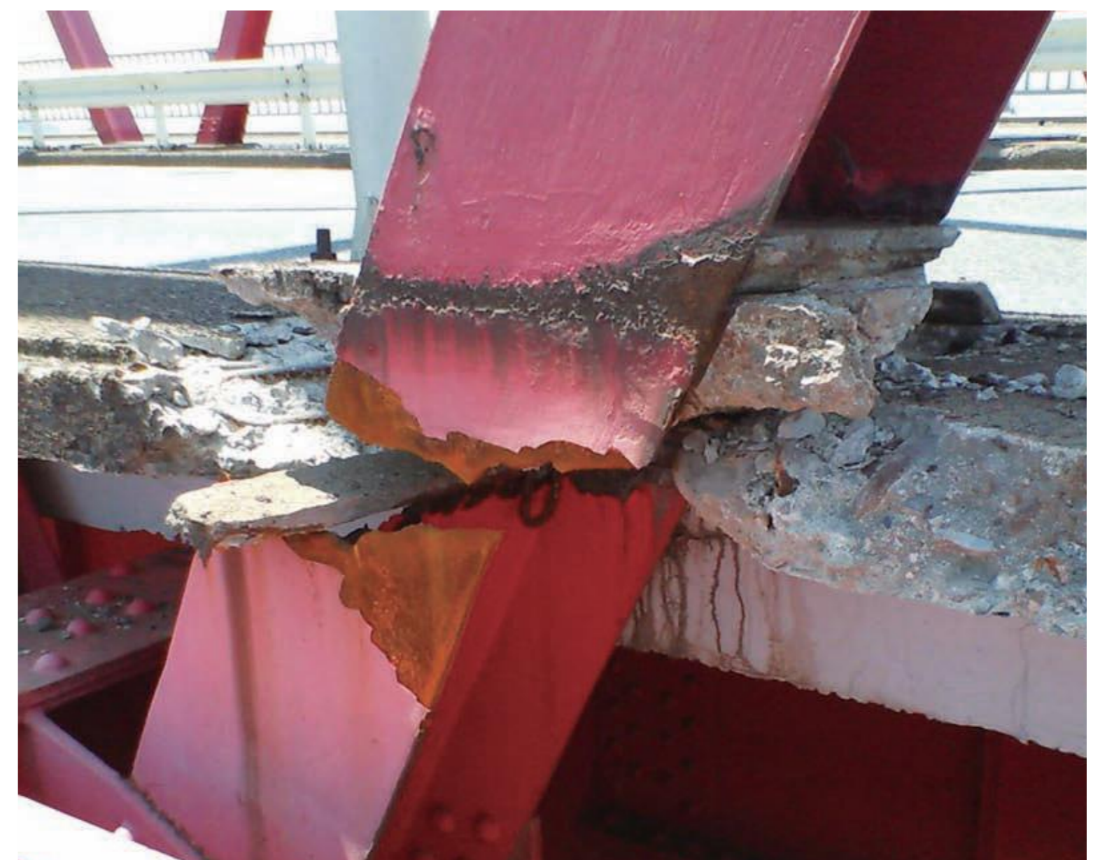
破断した鋼材、上下が完全に分離している
