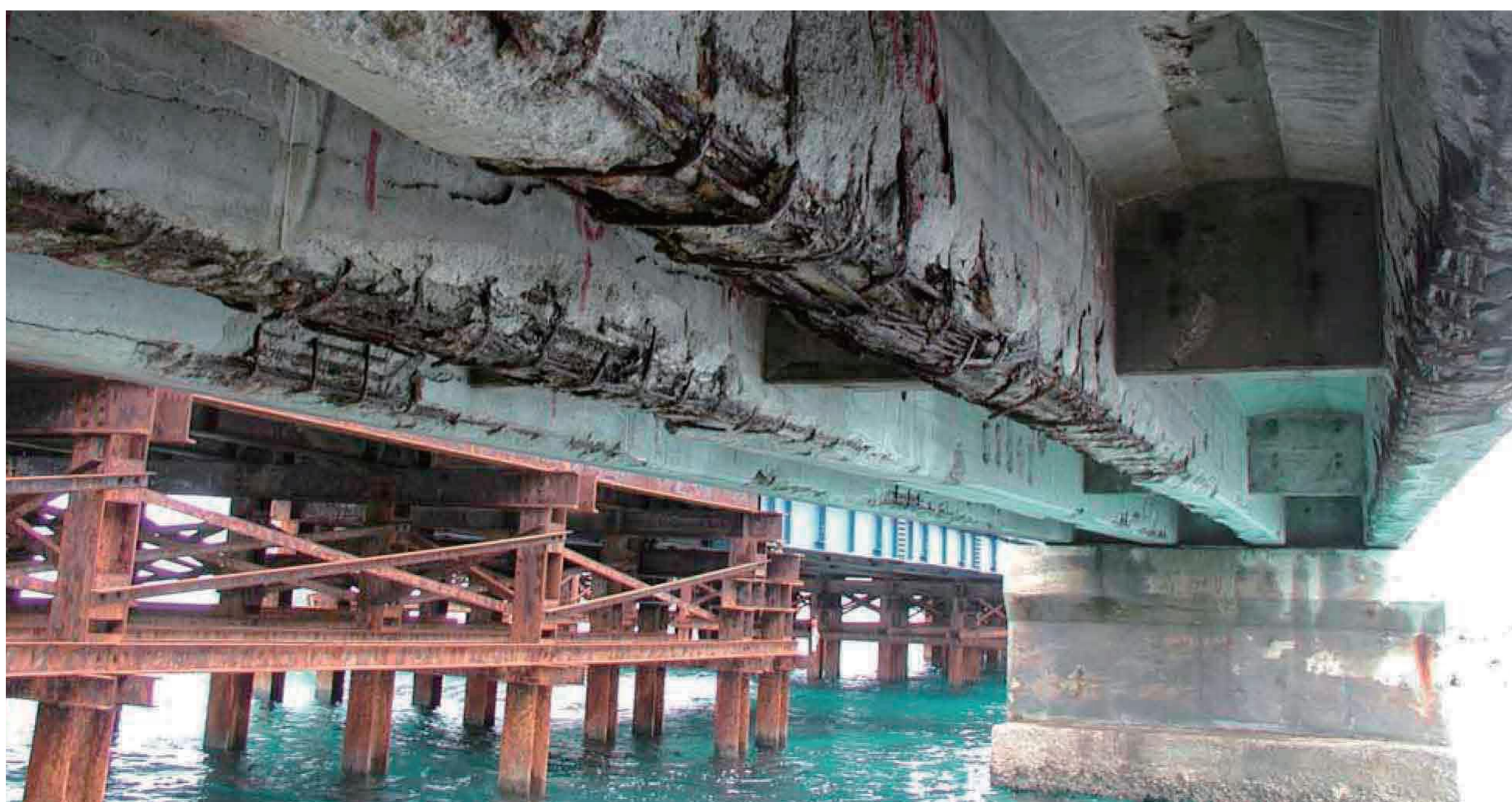
中の鋼材が腐食し、コンクリートが剥がれ落ちたところ
