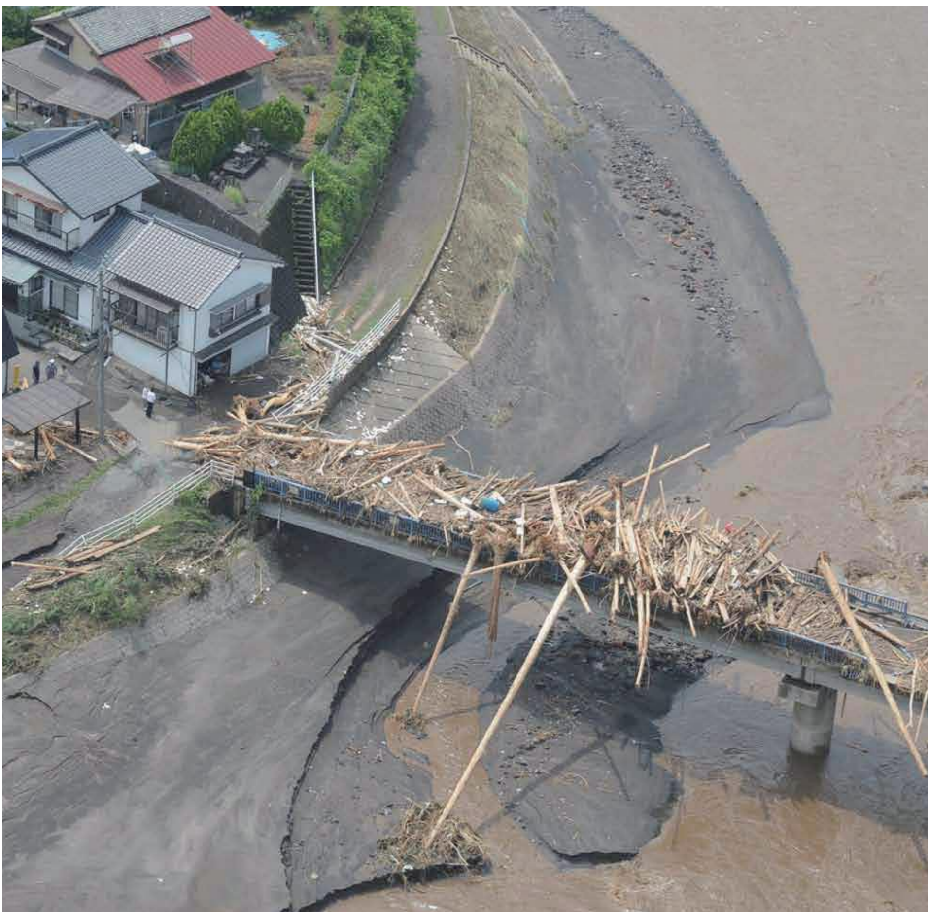
2012年7月の九州豪雨による激流で流木が橋梁に積み上がった (大分県竹田) 写真提供:毎日新聞社
