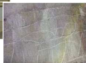
下部工のひび割れ
