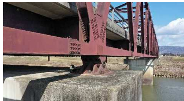
P2支承（固定）：ピンの脱落
