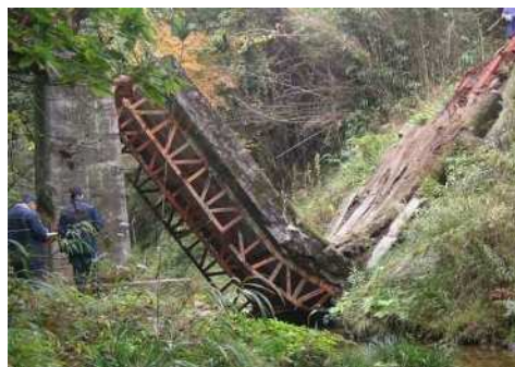
写真1 老朽化が原因で落橋した国内事例
