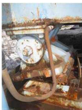
P3支承（可動）： 上部構造の移動に伴いローラーから脱落
