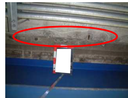
主桁の剥離・鉄筋露出
