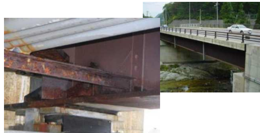
橋面排水の影響による腐食
