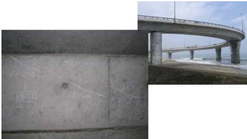
箱桁ウェブ面のひびわれ
