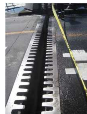
A1橋台上の伸縮装置の開き 橋軸方向：約40cm 橋軸直角方向：約20cm
