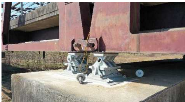
P3支承（可動）：ピンの脱落
