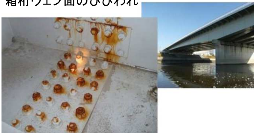
箱桁内のボルト部の腐食
