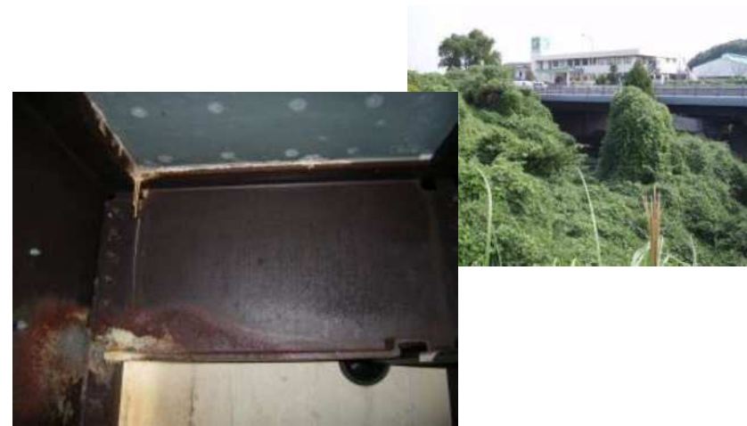
床版からの遊離石灰の析出
