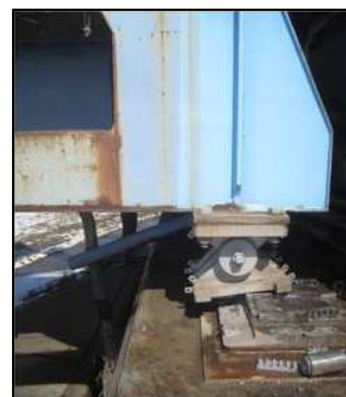
A1支承（可動）： 上部構造の移動に伴いローラーから脱落
