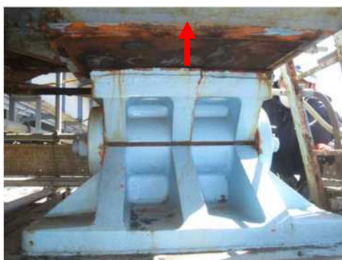
P2支承（固定）： 下弦材と上桁の間の溶接が外れ上部構造が移動
