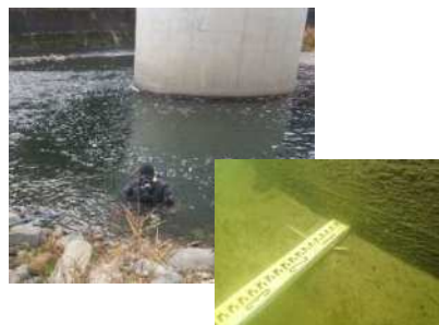
潜水調査による河床洗掘の把握
