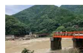
熊本県道の被害状況
