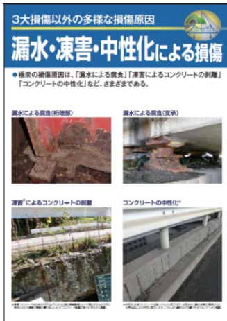
「道路の老朽化対策」パネル
