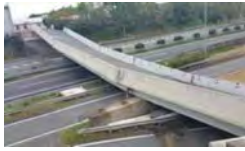
九州自動車道をまたぐ跨道橋の落橋 （県道小川嘉島線・府領第一橋） ※完了率は、平成29年3月末時点
