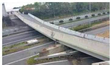
ロッキング橋脚を有する橋の落橋
