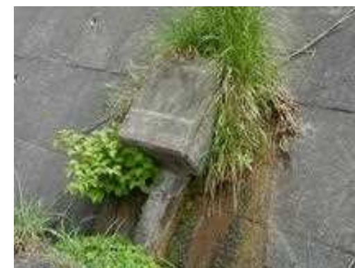
写真 アンカーの頭部からの湧水・雑草の繁茂の例
