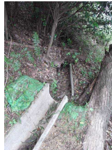
写真 排水溝の破損の例
