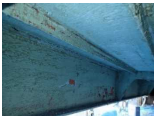
桁の塗装劣化やさびの発生
