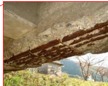
主桁の剥離、鉄筋露出
