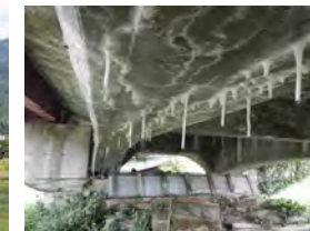
主桁のひびわれ
