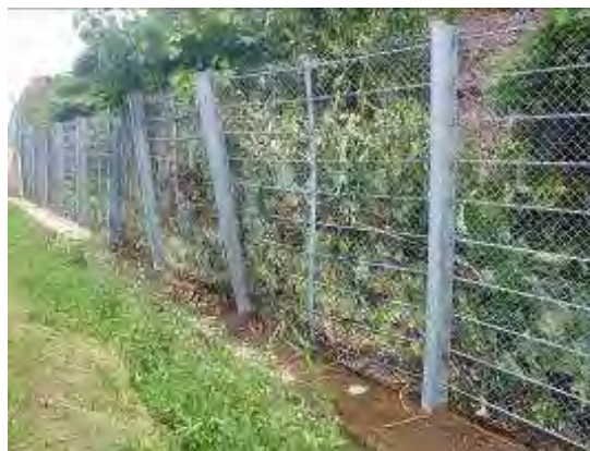
写真 落石防護柵の傾動の例
