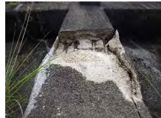
法砕工の老朽化損傷
