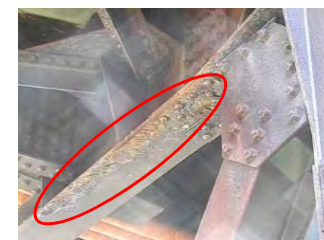
耐候性鋼材に層状の剥離
