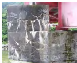
下部工にASRによる劣化が疑われる
