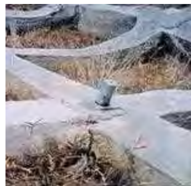
写真 受圧構造物の破損の例
