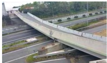
ロッキング橋脚を有する橋の落橋
