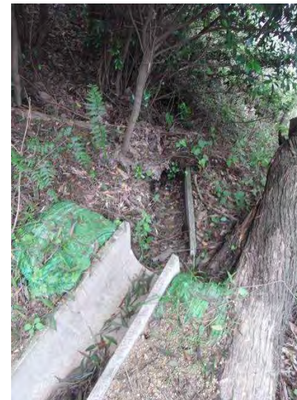
写真 排水溝の破損の例
