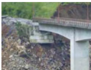
斜面変状による橋台の沈下
