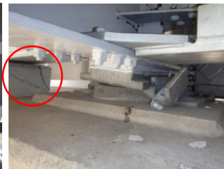
写真-6 支承の破損の状況
