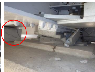
写真-6 支承の破損の状況
